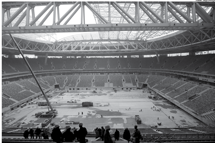
Queráris na Arena que vai sediar jogos da Copa de 2018 na Rússia. Há denúncias de corrupção e trabalho escravo na obra que pertencerá ao Zenit
